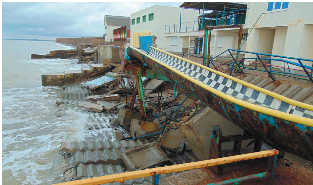
Рис. 3. Разрушенные берегозащитные сооружения в северной части с. Песчаное
