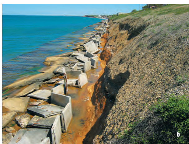
Рис. 2. Восстановившийся пляж на месте демонтированной ОСВН (а); полное разрушение ОСВН (б)
